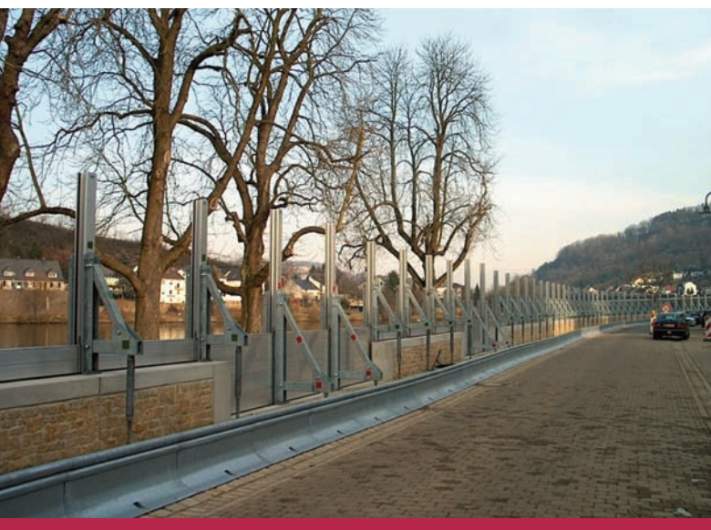
Hochwasserschutzmauer mit mobilen Schutzelementen in Oberbillig an der Mosel
